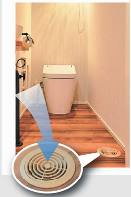
〈トイレの排気口の設置例〉
